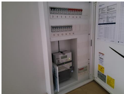
Elektrisk anlegg - [Sikringskap.]
