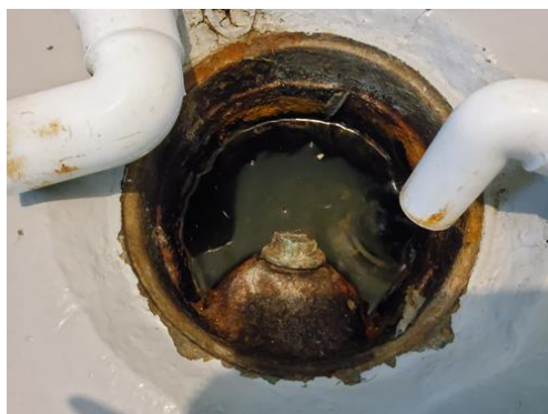
Fallforhold (gulv) - [Sluk i vaskerom.]
