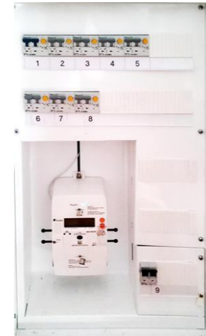
Forenklet vurdering av det elektriske anlegget - [Sikringskap]
