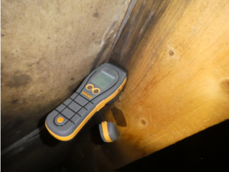
Treverk med fuktmerker var tørt ved befaring
