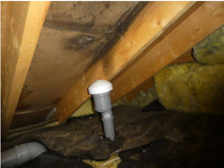
Fuktmerker i undertak grunnet tidligere feil med utlufting av avløp
