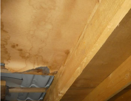
Utettheter i undertak Årstall: 1995 Kilde: Tidligere salgsoppgaver
