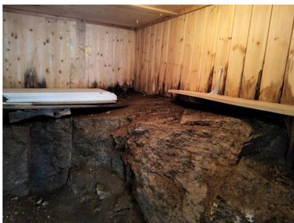
Kommentar - [Fukt/råteskader i krypekjeller]
