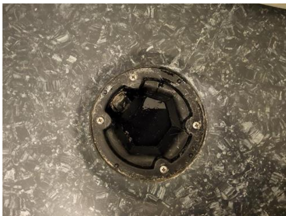
Avløpsrør (ink. sluk) - [Sluk bad]
