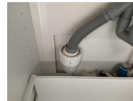
Avløpsrør i plast tilkoblet avløpsrør i støpejern.
