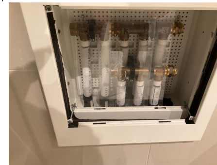
Rørskap rør i rør.
