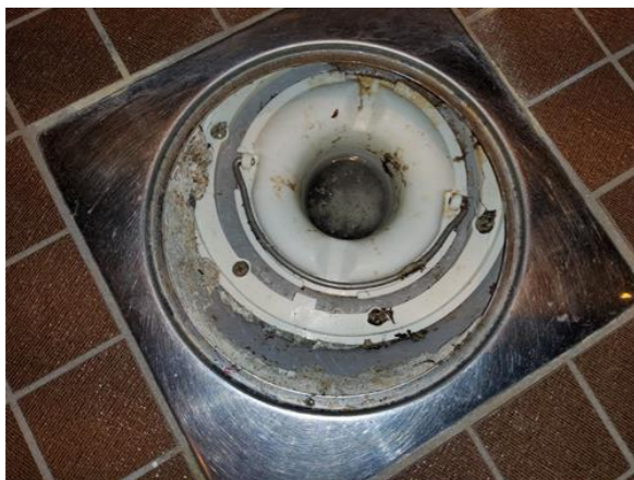
Fallforhold (gulv) - [Sluk bad 33A]
