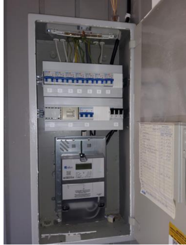
Forenklet vurdering av det elektriske anlegget - [Sikringskap 33 B-Tilbygg]
