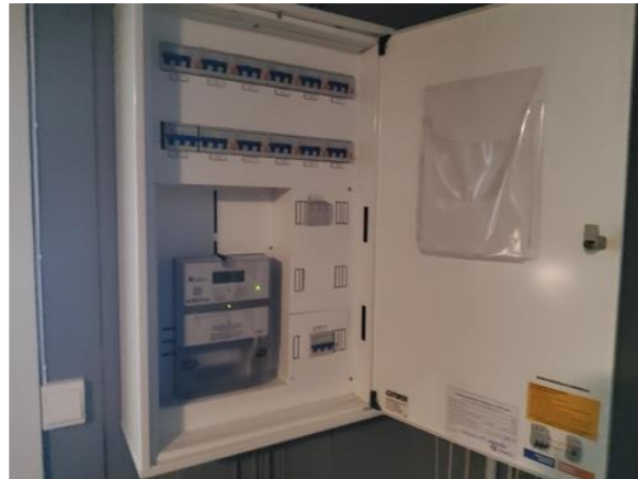
Beskrivelse - [Sikringskap 33 A]
