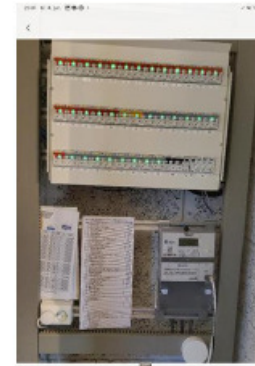
Elektrisk anlegg - [Sikringstavle]
