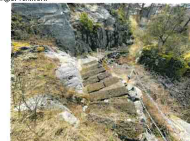
Eldre trapp med utbedring- og sikringsbehov
