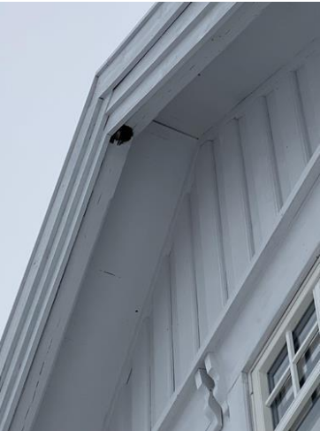
Fasader ink. kledning - [Råteskader, uthengssperrer]
