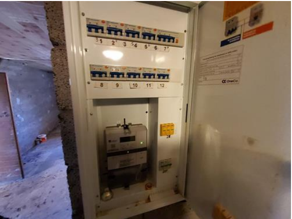
Elektrisk anlegg - [Sikringsskap]
