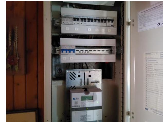
Elektrisk anlegg - [Sikringskap]
