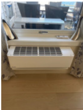
Varmepumpe type "luft til luft"
