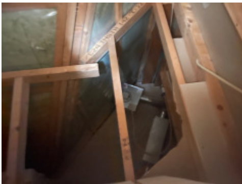
Kaldt loft med adkomst fra utleiedel: Motor for ventilasjon.
