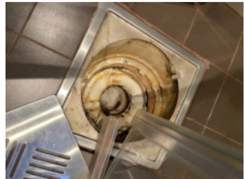
Plastsluk med oppsamlerkopp
