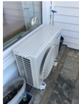
Terrassen: Utedel til varmepumpe
