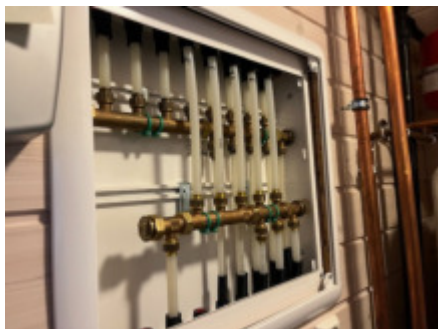
Rørskap på tekniskrom.
