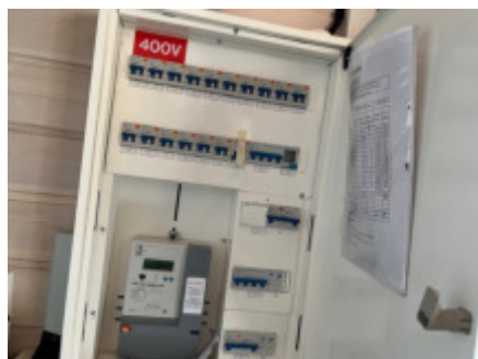
Sikringsskap plassert i teknisk rom.
