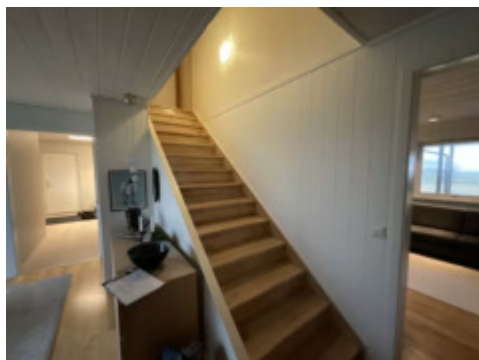
Det er ikke etablert rekkverk og håndløper på vegg i trapp til 2 etg.
