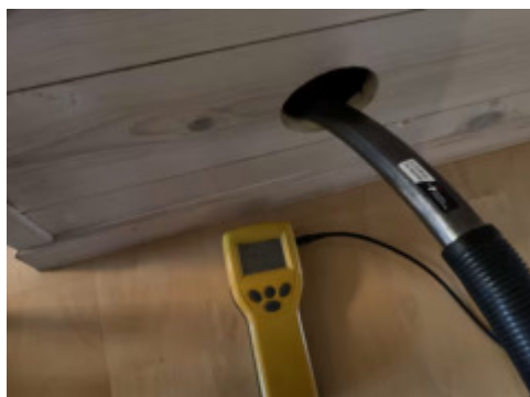
Resultat av fuktmåling viser under 7%
