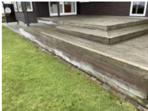
Det er ikke etablert rekkverk på terrasse.
