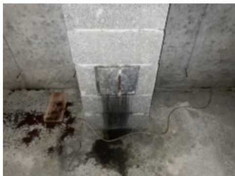
Det trekker noe sotvann ut fra sotluke i kjeller.
