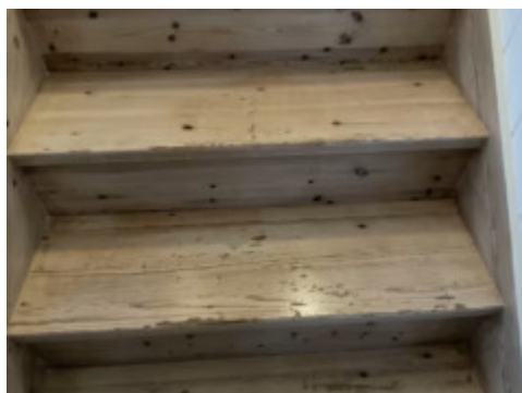
Slitasje i trinn i trapp til 2 etg.
