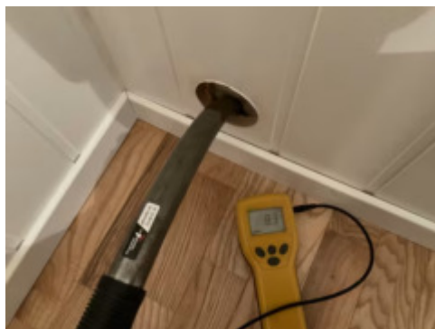
Resultat av fuktmåling viser ca. 8%
