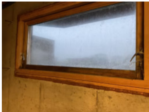
Tegn etter kondens på vindu i grunnmur.
