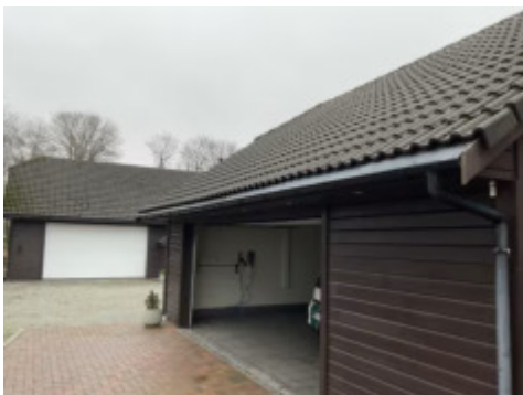
Det registreres nedbøy i takflaten over garasjeport.
