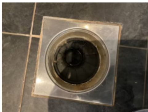
Pga. fliselim er det ikke mulig å kontrollere overgang klemring og membran.
