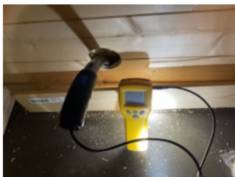
Resultat av fuktmåling viser ca. 15%
