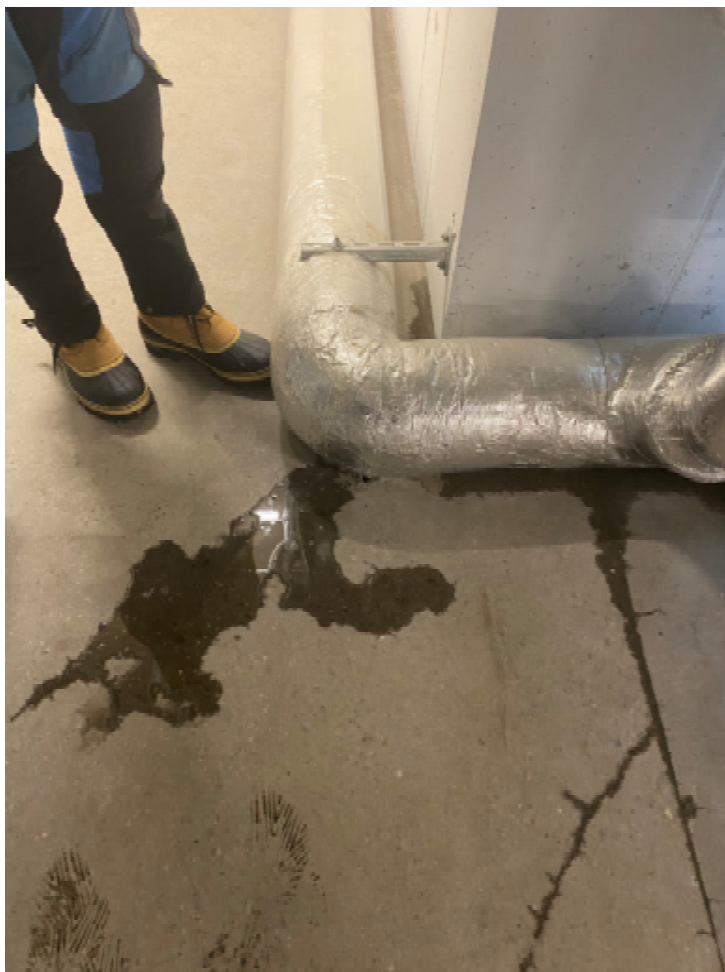
Bilde 4 Riss teknisk-/sprinklerrom. Riss ved vinkelendringer (Fastholding)
