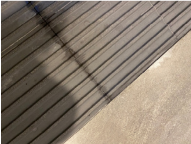
Bilde 5 Fukt i fuge på taktillflis
