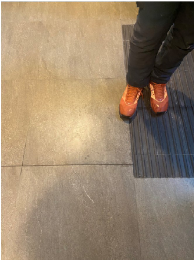
Bilde 6 Fukt i fuge.
