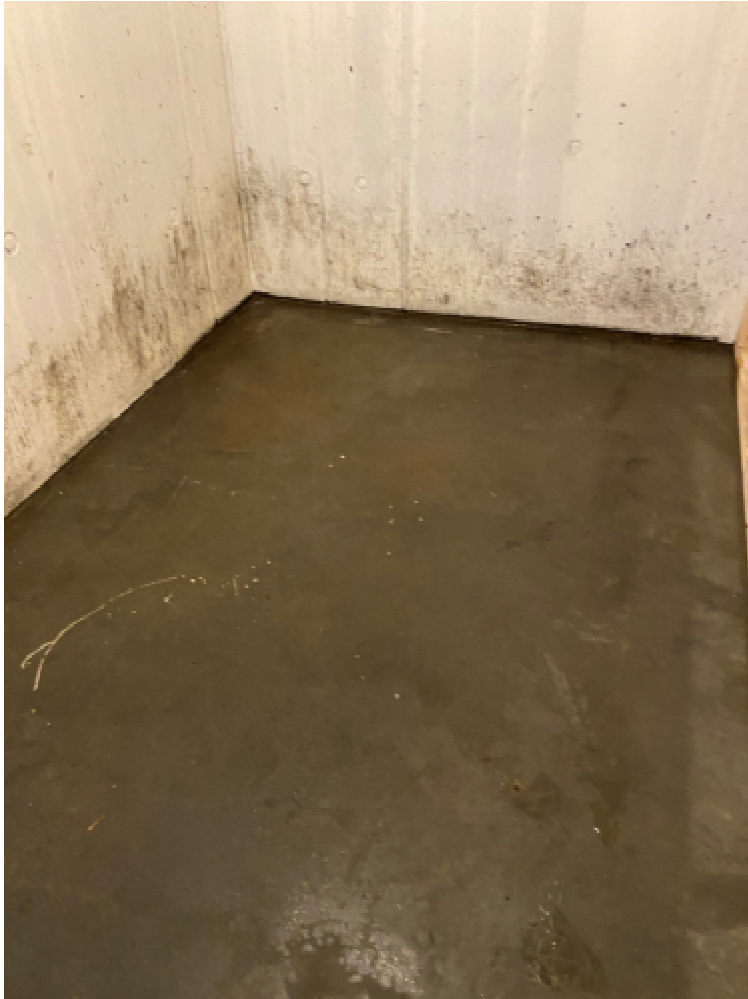
Bilde 7 Bod F11 jevnt fukt over hele gulvflaten. Soppdannelse opp langs vegg
