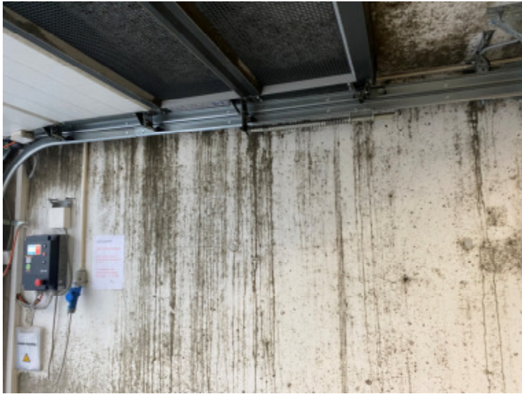
Bilde 1 v/kjøreport Misfarging/ sopp pga kondensering
