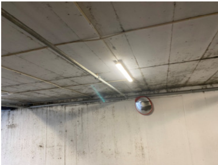
Bilde 2 Misfarging/sopp pga kondensering i betonghimling v/kjøreport
