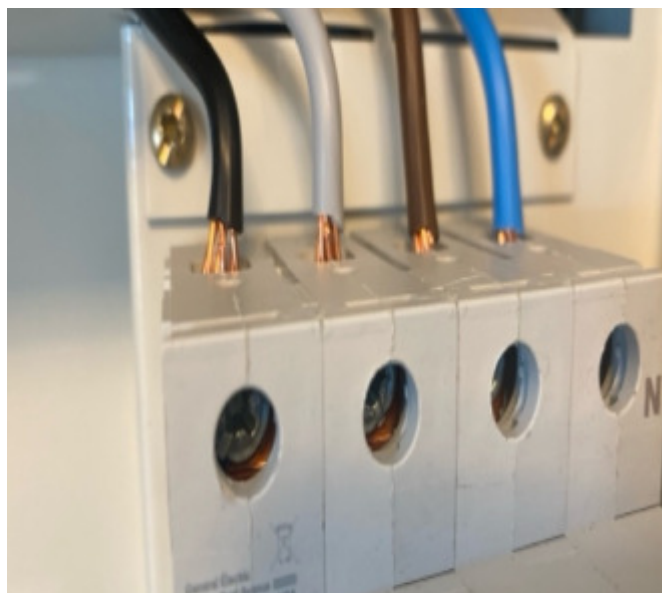
Bilde 3 Ledere tilkoblet med synlig kobber.
